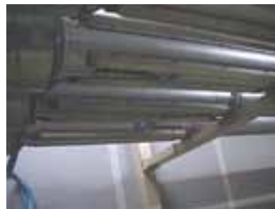
Clear Tube, installiert
