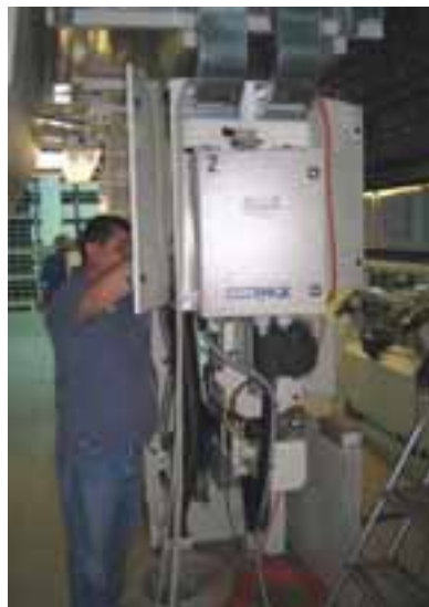
Instalación ESA ACE Rotostatic
