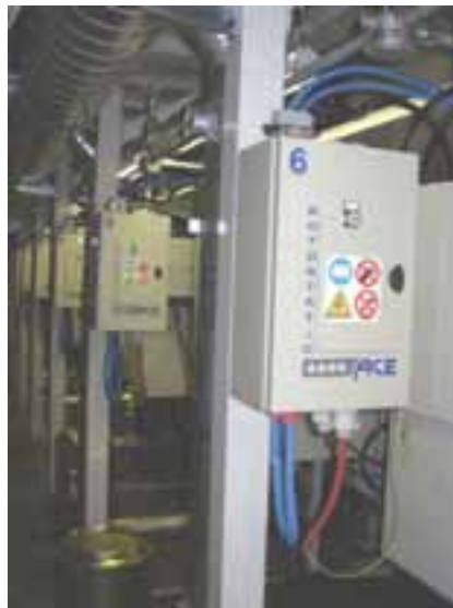
Generadores sistema ESA ACE Rotostatic
