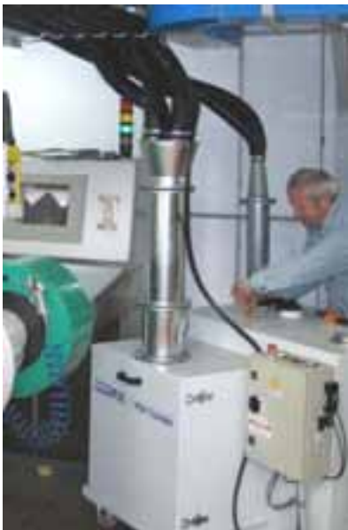
Instalación Web Cleaner
