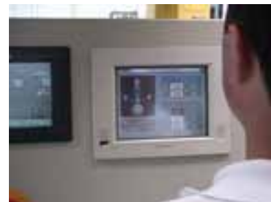
Start-up supervisore impianto ESA
