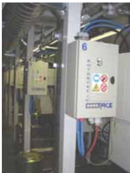
Generatori sistema ESA ACE Rotostatic
