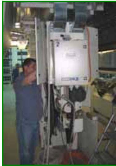
Instalación ESA ACE Rotostatic
